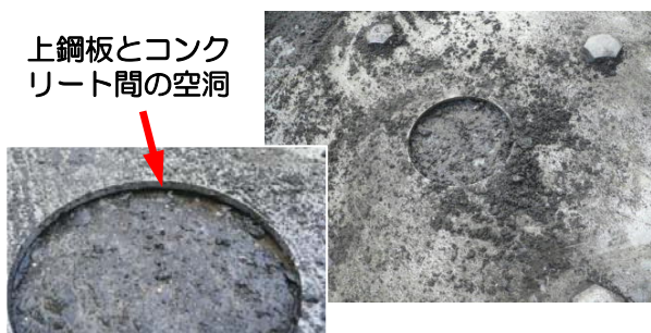
写真Ⅱ-2 打設孔の変状状況
