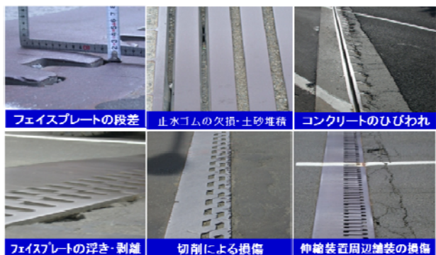
写真Ⅲ-2：代表的な損傷
