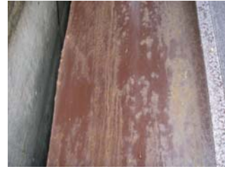
写真-4 漏水等が生じている箇所の塗膜の状況
