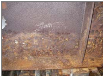
写真-1 漏水等が生じている桁端の腐食状況
