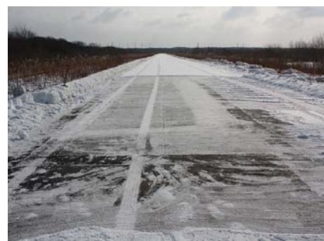
写真-2 POC舗装版冬季路面状況
