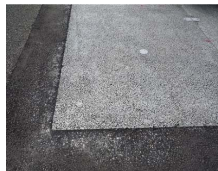
写真-3 As部の状況
