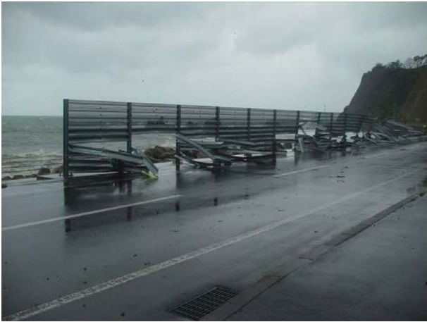
写真-17 フェンスの損傷事例
