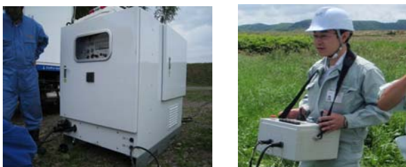
写真－4 操作盤及びコントローラ
