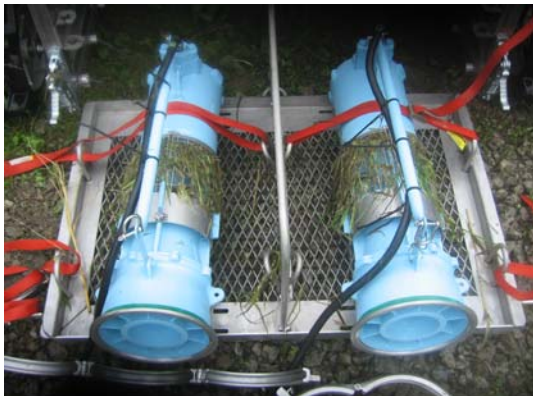
写真-14 草の吸い込み状況
