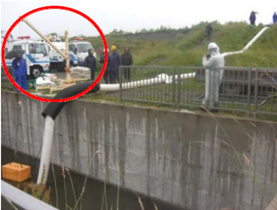
写真-21 可搬装置による排水ポンプ設置状況 （旭川開発建設部名寄河川事務所での訓練）
