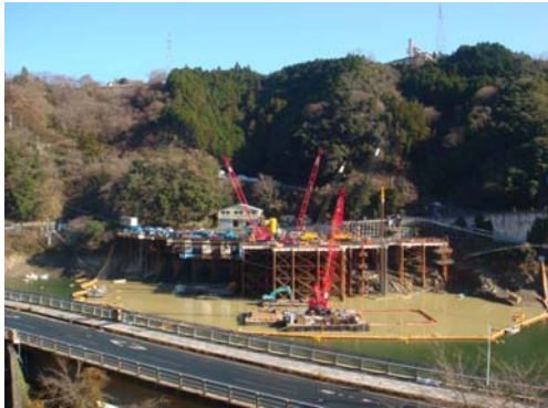
写真-5 湖内工事の行われている鹿野川ダム貯水池 (平成 24 年 12 月)
