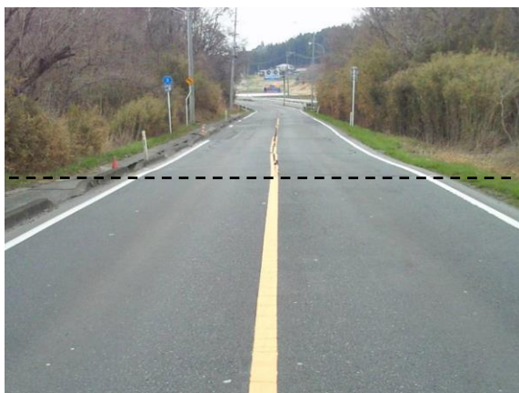
図-16 県道3号塩釜吉岡線の路面状況
