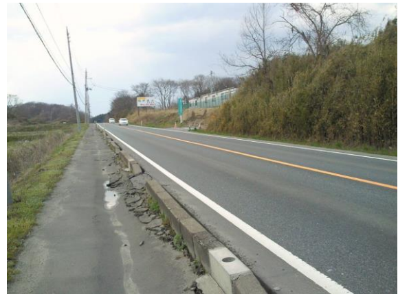
図-18 歩道部と車道部の損傷状況（県道3号）
