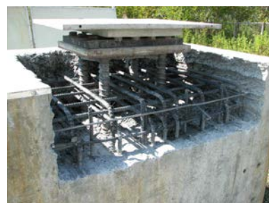
写真-8 試験終了後の状況
