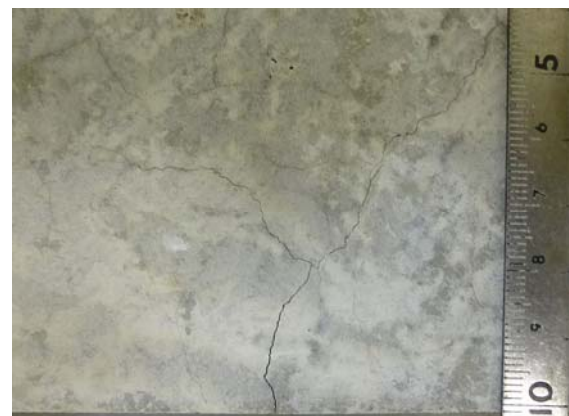
図-2.12 ひび割れ状況 (HA, アルカリ量 3.8kg/m 3 )
