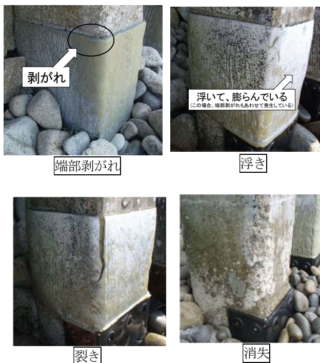
写真-3.11 損傷の形態（右側が海側）
