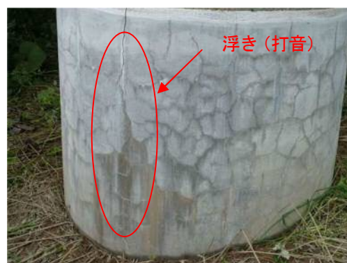
写真-4.3 橋脚のシート工法に生じた浮き (保護モルタルのひび・エフロ・浮き)
