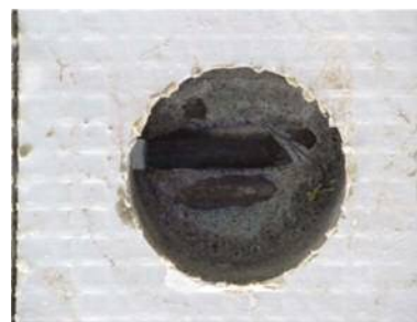
写真-4.14 鉄筋の腐食状況
