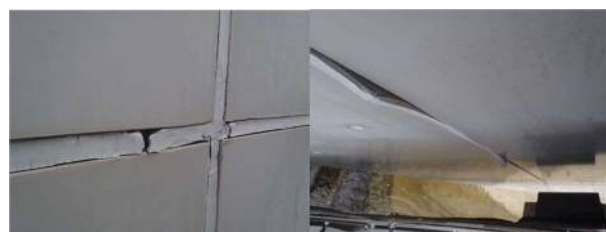
写真-2.2 目地材の劣化事例
