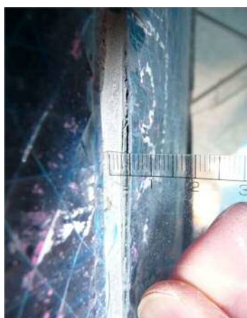
写真-4.10 剥離状況
