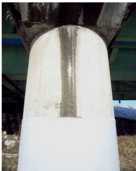
写真-4.6 漏水状況
