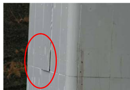
写真-2.3 埋設型枠の剥離事例
