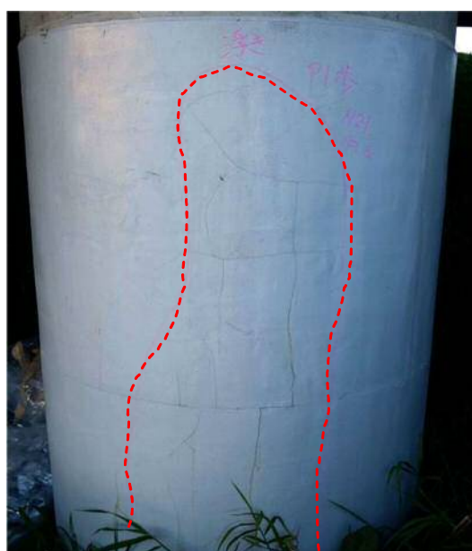
写真-4.5 変状状況の外観（点線は浮きの範囲）
