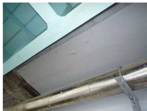
写真-4.2 床版下面のシートに生じた浮き
