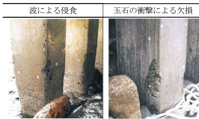
写真-3.9 脚柱の損傷状況の一例
