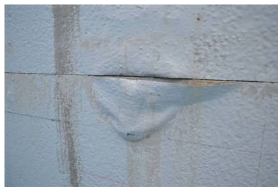
写真-3.2 ウレタンの剥がれの事例
