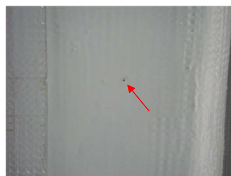
写真-4.15 水抜き孔
