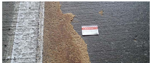
写真-4 ニート工法の剥がれ
