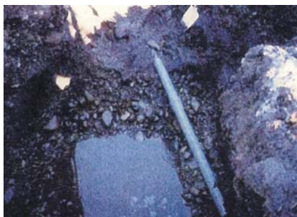
写真-1 パイプラインの漏水状況 10) (口径75mm, PVC管, 23年経過時点)
