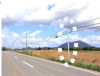
写真-2 通信線の増加に伴い通信用の電柱が増設された事例
