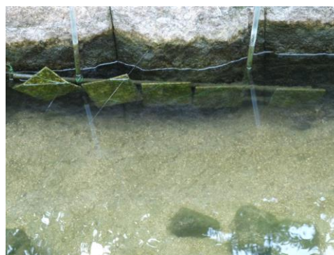
写真-9 平成24年6月せせらぎ水路Aのタイル
