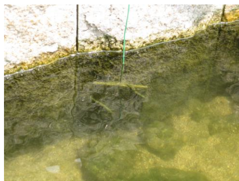
写真-7 平成22年7月せせらぎ水路Aのタイル
