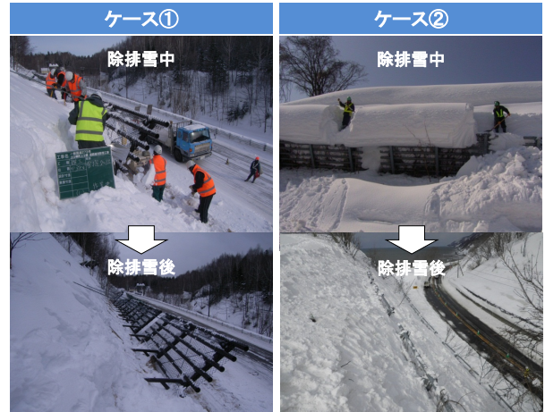
写真-6 雪崩予防柵周辺の除排雪状況
