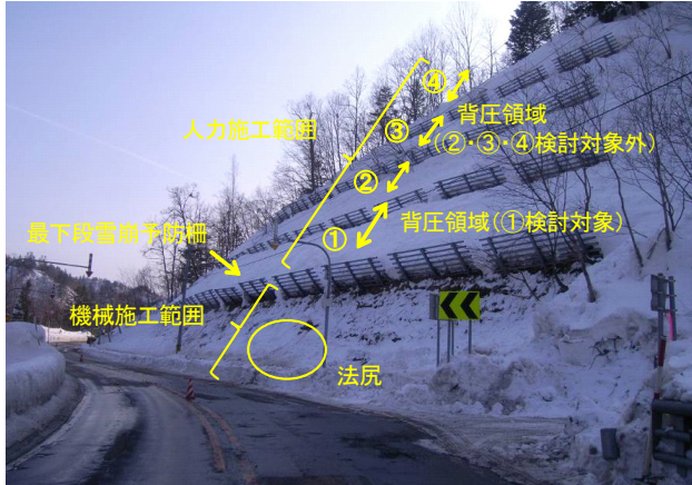
写真-4 雪崩予防柵の設置状況と検討対象
