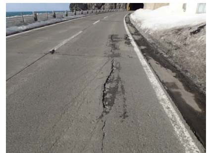
写真-3 ひび割れ (縦断方向)
