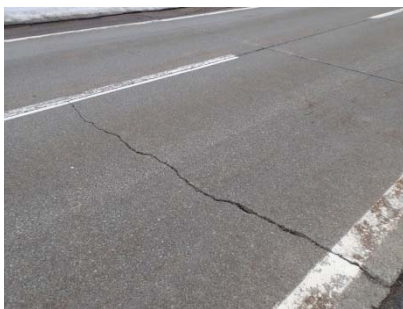
写真-4 ひび割れ (横断方向)
