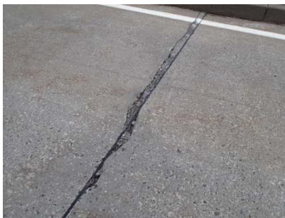
写真-1 目地部の破損 (角欠け)
