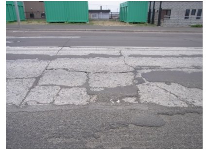
写真-12 疲労破壊によるひび割れ
