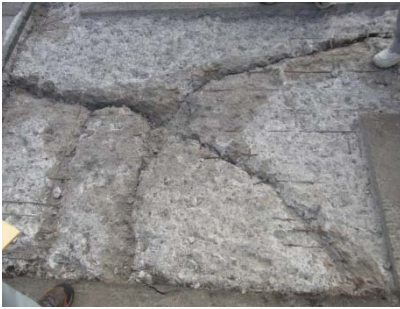
写真-10 疲労破壊による亀甲ひび割れ
