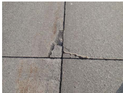
写真-2 目地部の破損 (隅角部)
