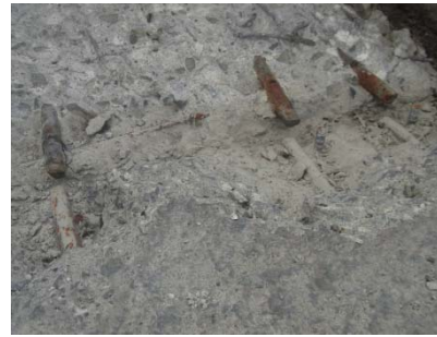
写真-11 破断したダウエルバー
