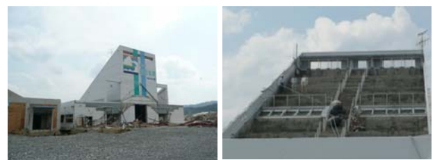
写真-4 壊滅的な被害を受けながらも津波から避難者の命を守った「道の駅」の避難階段
