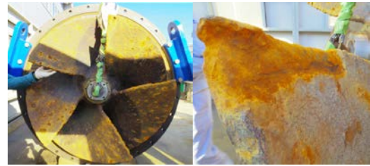
写真-5 K排水機場の羽根車の状況 （左：全景 右：端部拡大）
