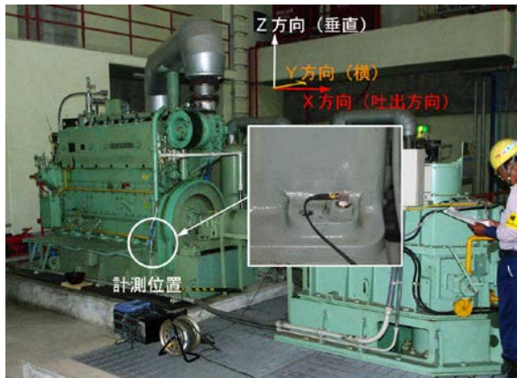
写真-15 原動機の振動計測位置
