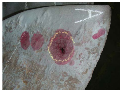
写真-4 N排水機場の羽根車の状況
