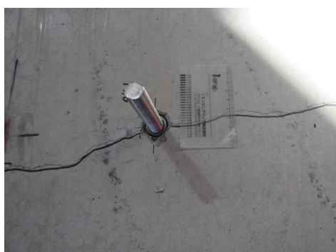
写真-1 アンカー周辺のひび割れ発生状況
