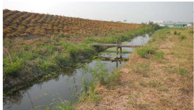
写真-2 サハ・ラタナナコン工業団地の輪中堤
