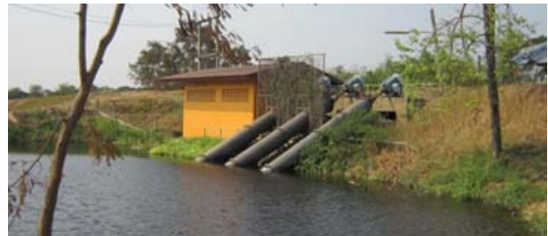
写真-3 サハ・ラタナナコン工業団地の排水設備
