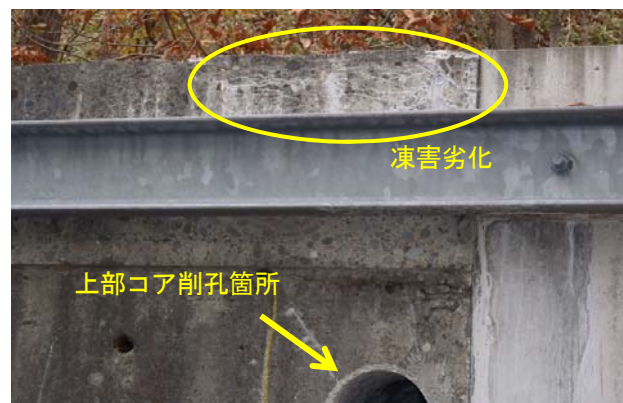
写真-2.1.4 暴露試験体裏側上部の凍害劣化
