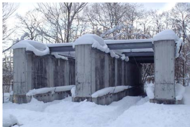
写真-2.1.1 初代十勝大橋コンクリートの暴露状況
