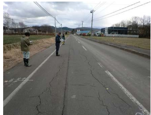
写真 2.2-1 目視による点検状況（ひび割れ）
