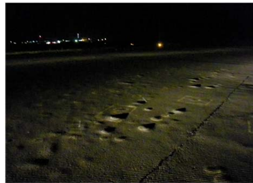
写真-2 ブリスタリングの確認状況
