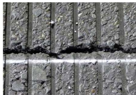
写真-1 施工継ぎ目の開いた状況
