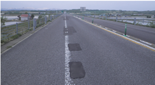
写真-1 名寄美深道（上）と深川留萌道（下）のポットホール
