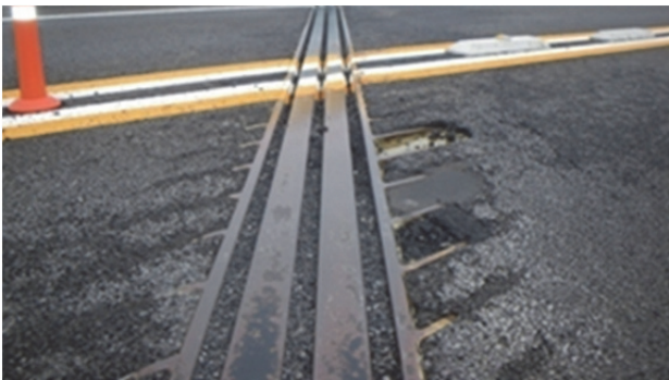
写真-2 函館江差道の破損（橋梁ジョイント部）
