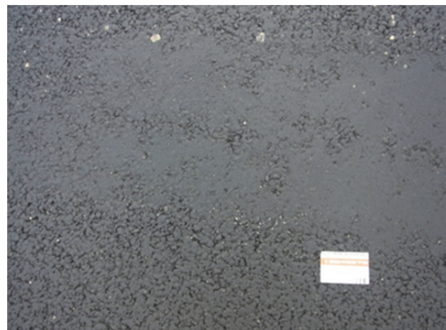
写真-5 ダレによってアスファルトモルタル分が浮き出し舗装表面がフラッシュしている状況
