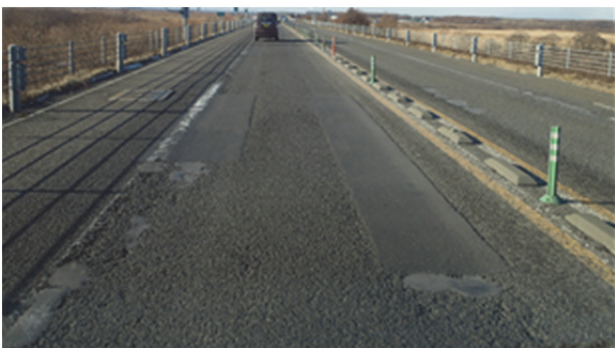
写真-3 日高道のわだち掘れとポットホール
