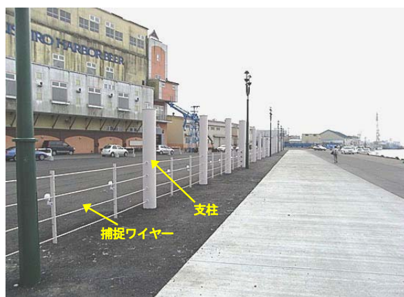
図-1 津波漂流物対策施設(釧路港)
