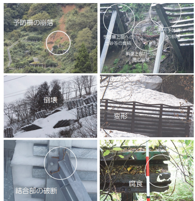
図 1 雪崩対策施設の損傷例
