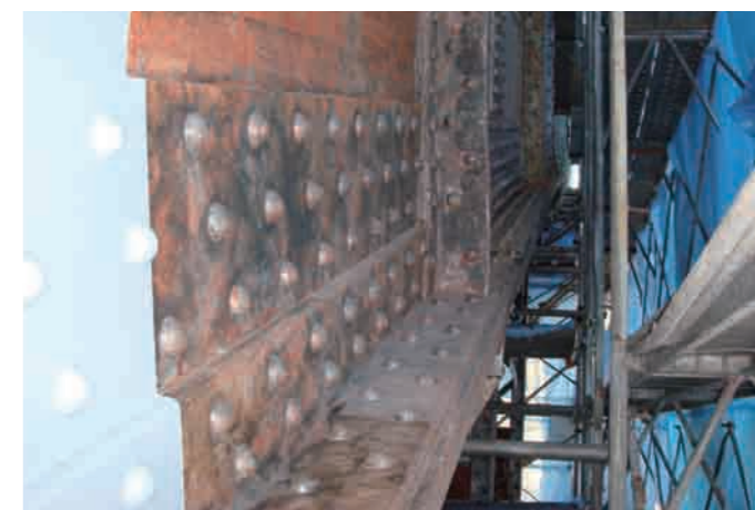
塗膜の除去が完了した部分から順次重防食塗装を施しました。写真の手前(左側)が塗装した部分です。
