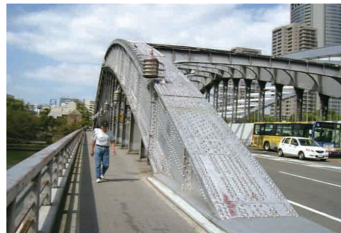
施工前の桜宮橋は部分的に塗膜のムラやひび割れなどがありました。
