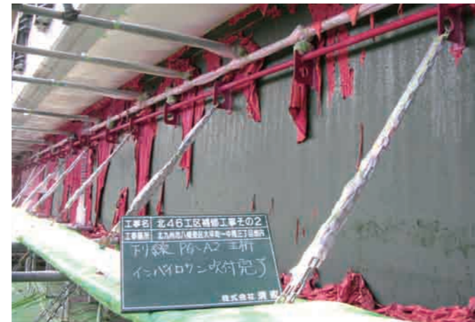
施工箇所によっては自重でかなりの部分の塗膜がはがれました。
