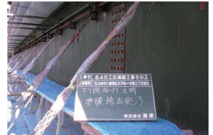
塗膜を除去したことで、インバイロワン工法は完工です。さび部の処理は電動工具を使用しました。
