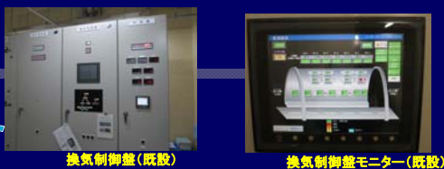
換気制御盤(既設)
