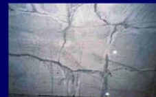
コールドジョイントとひび割れとの組合せでブロック化
