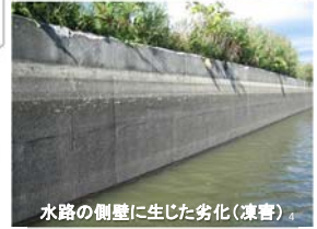
水路の側壁に生じた劣化(凍害)
