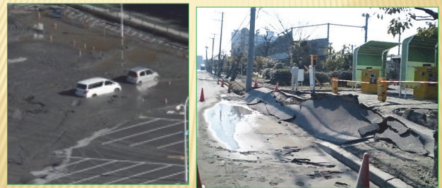
液状化被害発生状況
