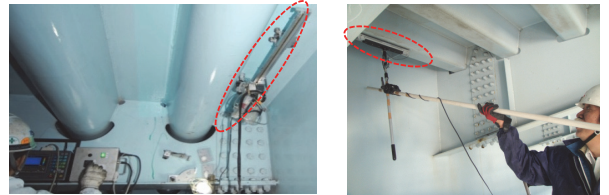
鋼床版の下側に超音波センサを設置し、調査している様子
