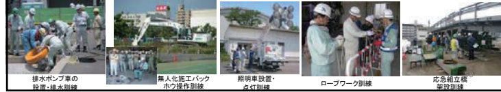
排水ポンプ車の設置・排水訓練 無人化施工バックホウ操作訓練 照明車設置・点検訓練 ロープワーク訓練 応急結立構築設置訓練
