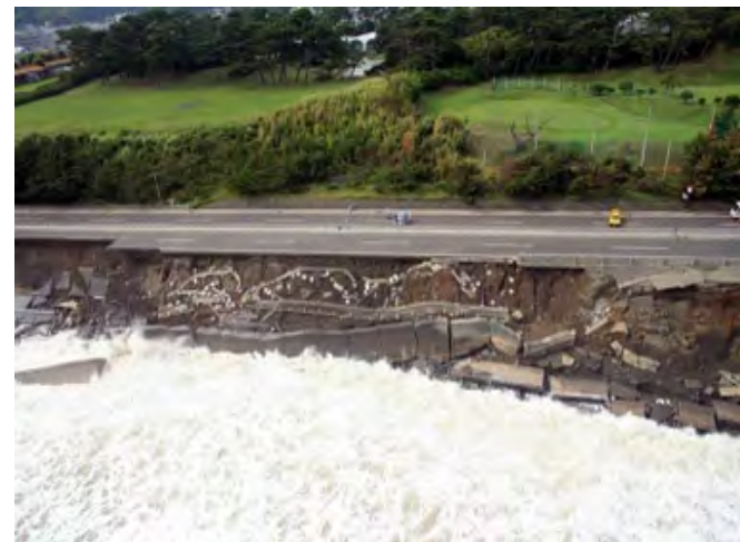
国道1号西湘バイパス (2007. 9)
