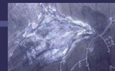
単一のひび割れが交差しブロック化
