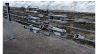
緊急開放金具の設置状況
