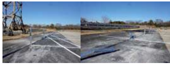
衝突後の防護柵の破損状況 (2012年1月)
