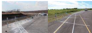
衝突後の防護柵の破損状況(2016年3月、8月)
