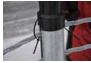
バンドによりワイヤーに固定
