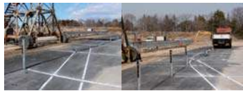
衝突後の防護柵の破損状況 (2014年3月)
