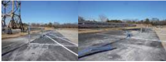
衝突後の防護柵の破損状況(2012年1月)
