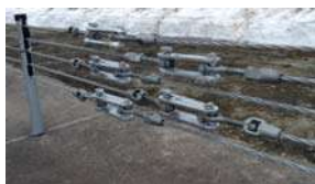
緊急開放金具の設置状況
