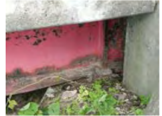
桁端部の腐食
