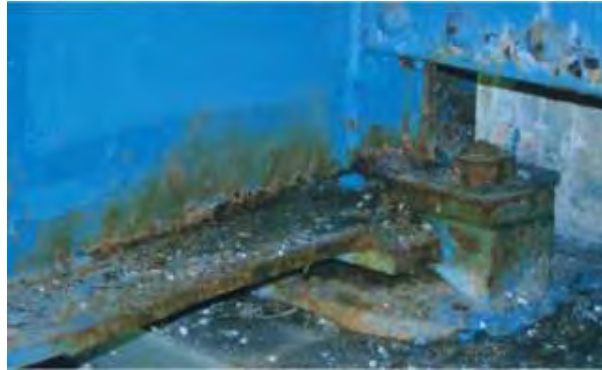
支承部周辺の腐食
