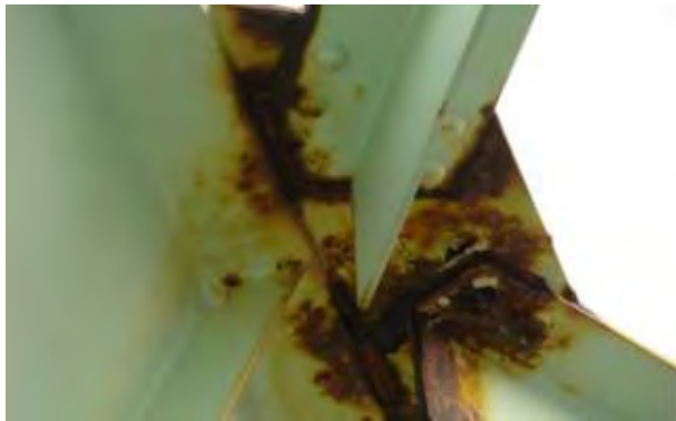
ガセット、ガセット取付け部の 腐食
