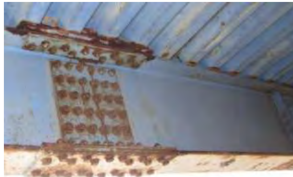
高力ボルトまわりの腐食
