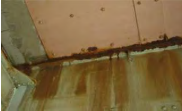
床版からの漏水による 上フランジの腐食
