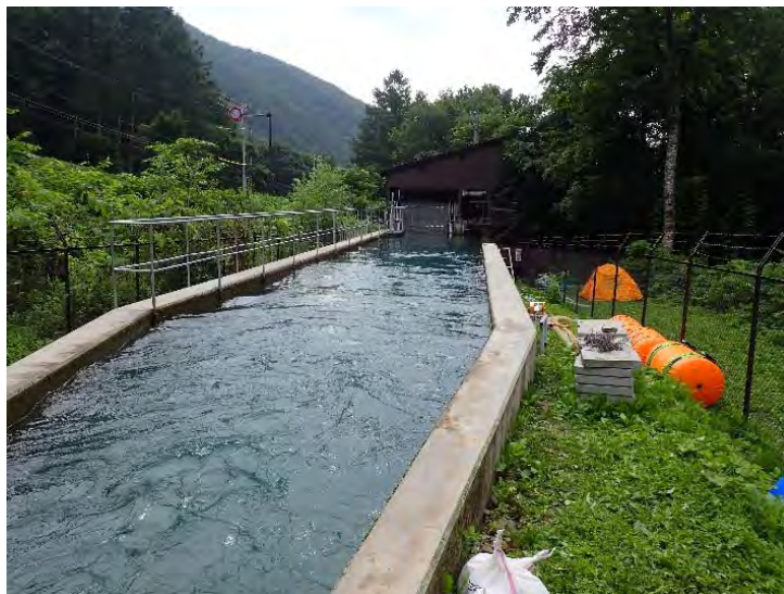
水槽兼沈砂池(運用中)
