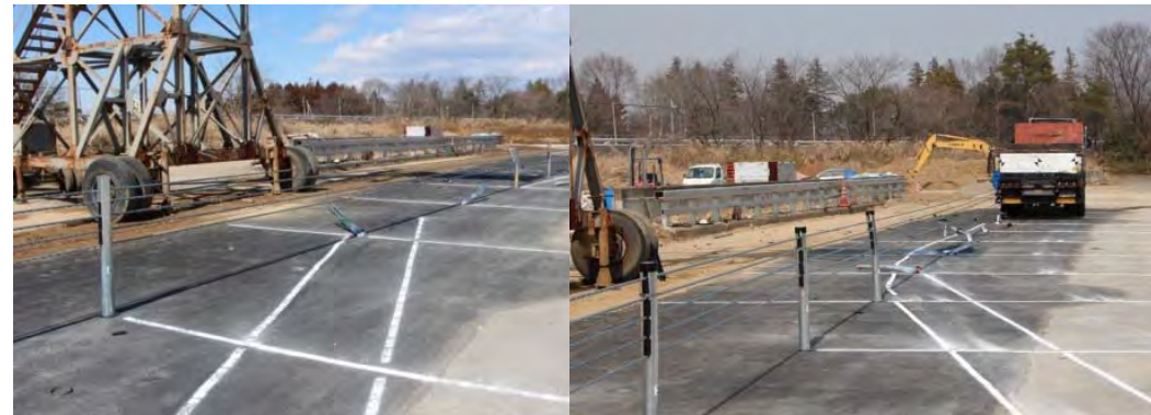
衝突後の防護柵の破損状況(2014年3月)
