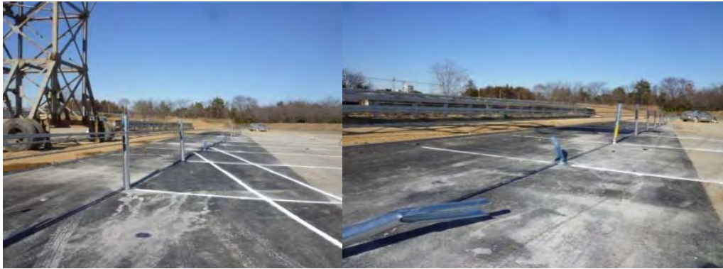
衝突後の防護柵の破損状況(2012年1月)
