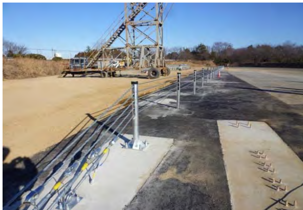
防護柵設置状況 (端末)
