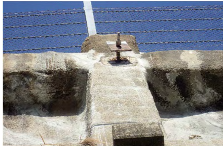
腐食により破断したアンカー
