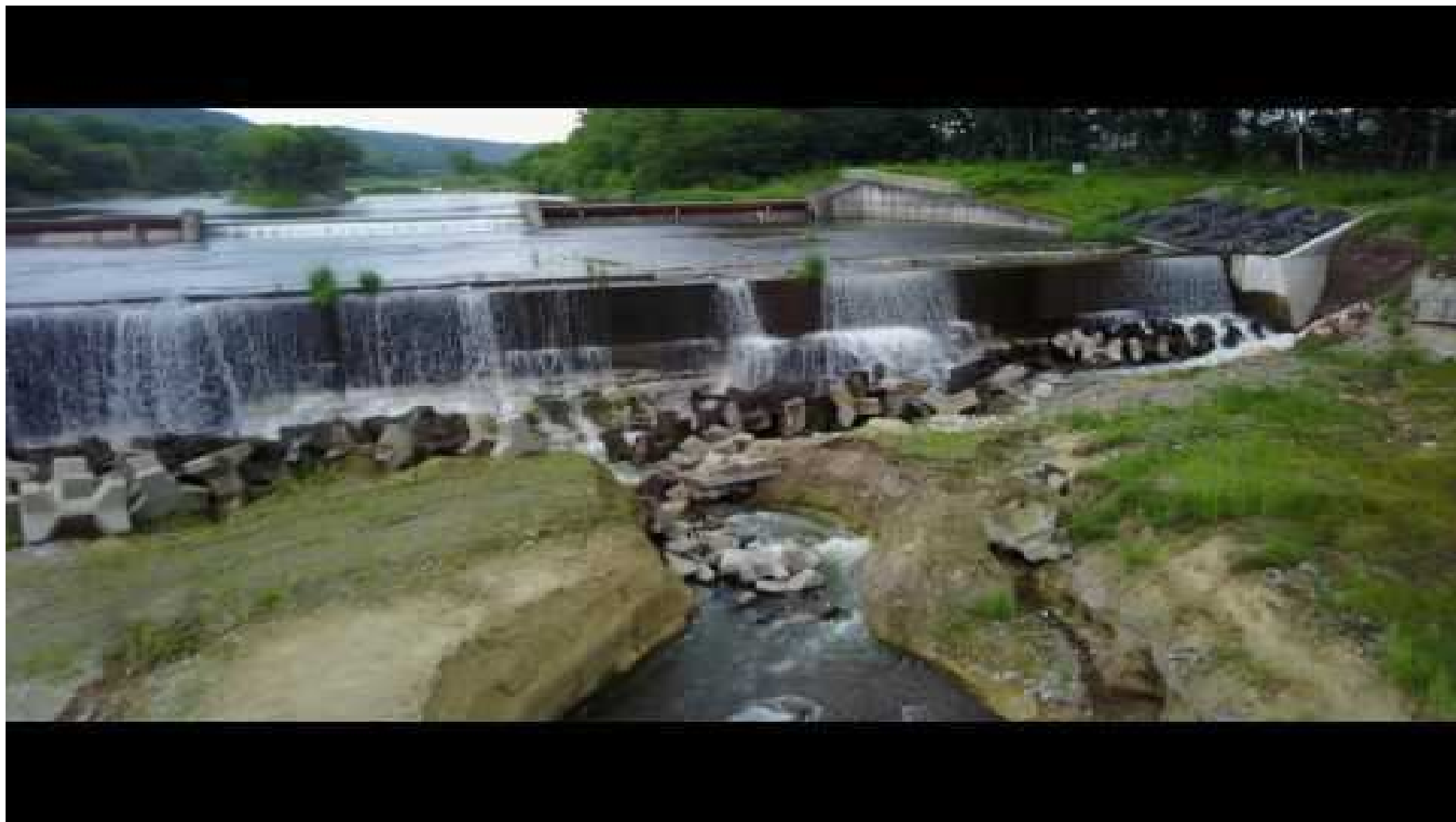
頭首工の被災（然別川） 撮影 Yasuyuki Shimizu
