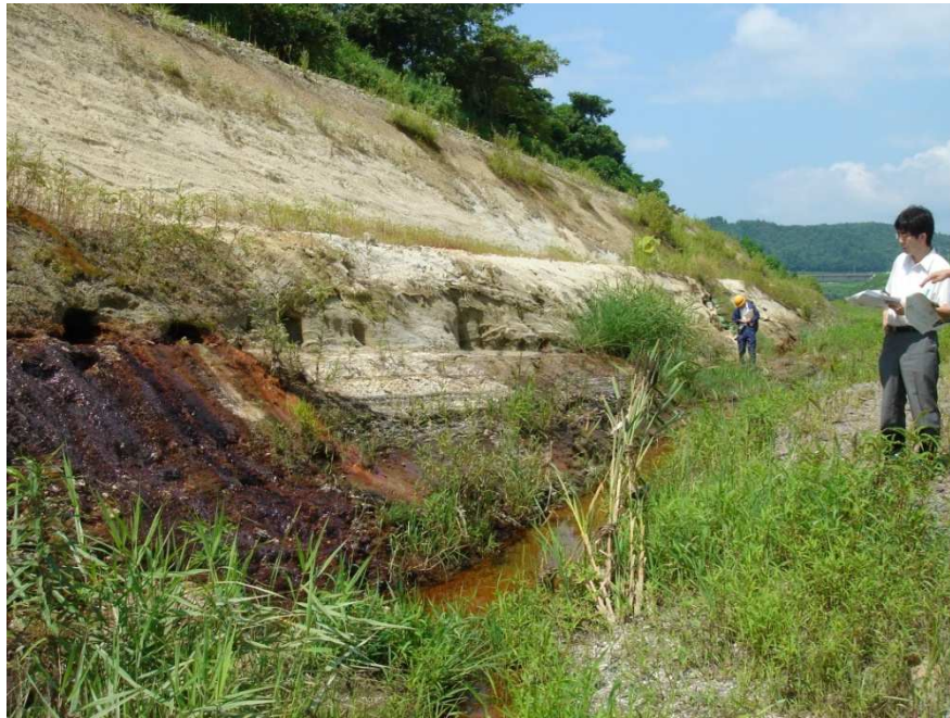
錆汁状の水の発生
