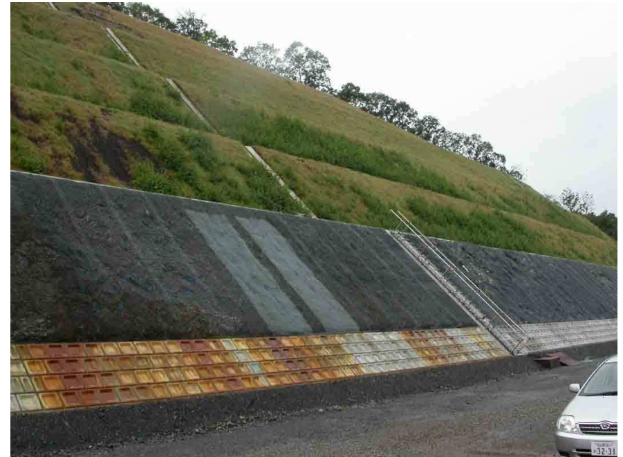
のり面植生の劣化例
