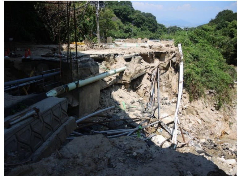
県道34号線の陥没
