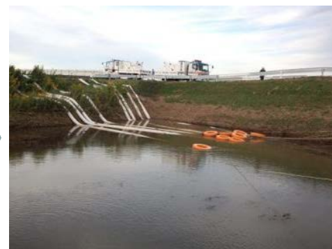
撮影日: 10月20日(15:00) 状 況 : 現地排水状況
