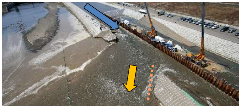
千代田実験 水路幅 B=8\text{m} 河床勾配 lb=1/500
