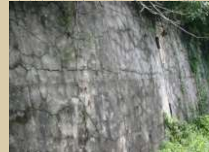
アルカリシリカ反応によるひび割れ
