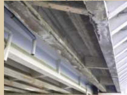
塩分浸透による鋼材腐食
