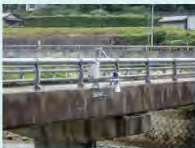
現場実装された危機管理型水位計
