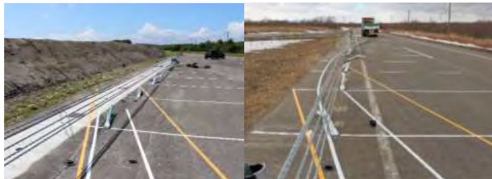
衝突後の防護柵の破損状況(2020年7月, 3月)
