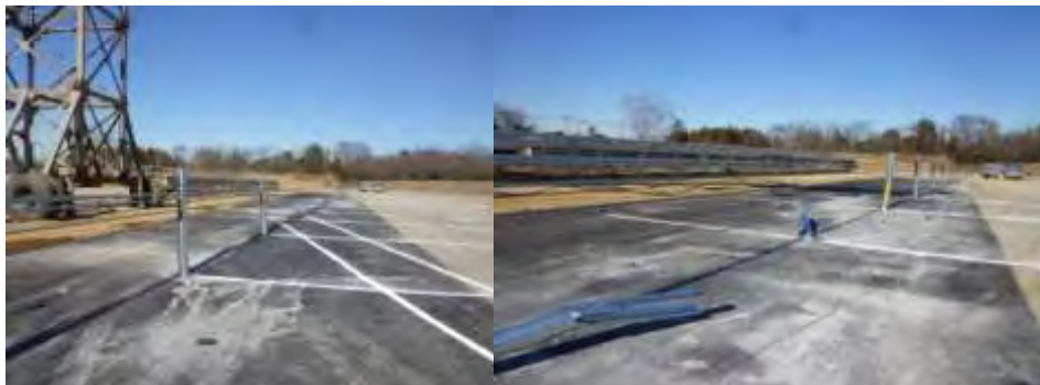
衝突後の防護柵の破損状況(2012年1月)
