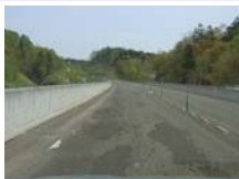
高規格道路の排水性舗装の破損状況
