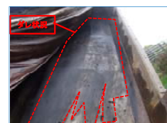
アスファルト混合物のダレ状況
